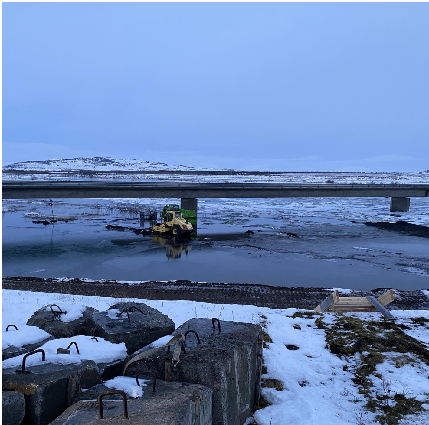
Des 2021, Klaka stífla í árfarvegi neðan brúar. Flóð kemur ekki fram á mæli sem er staðsettur ofan brúarstæðis
